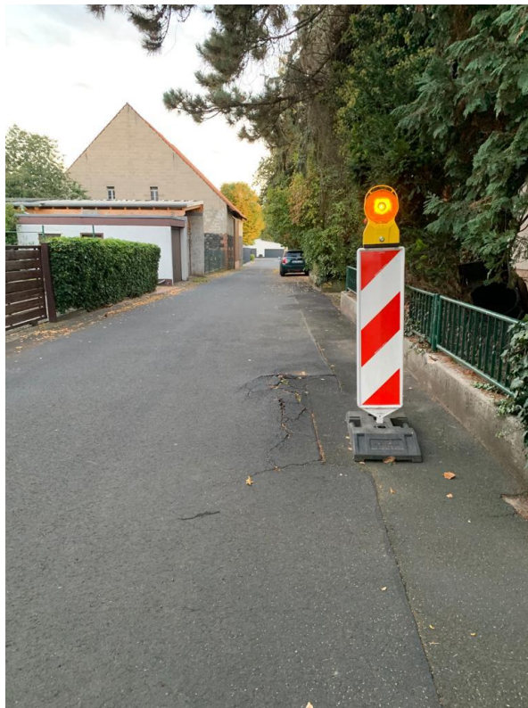
Wurzeln vom angrenzenden Grundstück (Schramm) zerstören die Straße
