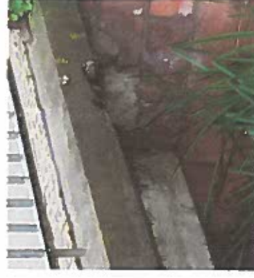
Risse an Brücke
