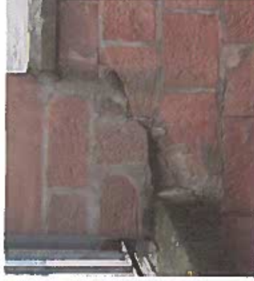
Risse an Brücke
